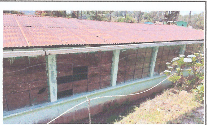
Foto 2: ÁREA DE LA PARTE DE ATRÁS DONDE SE CONTEMPLA REALIZAR EL MEJORAMIENTO DE TECHO, MANTENIMIENYO DE COSTANERAS Y MEJORAMIENTO DE CANALETAS CON SU RESPECTIVA CAIDA DE AGUA.
