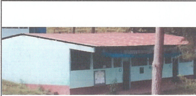
Foto 1: ÁREA FRONTAL DONDE SE CONTEMPLA REALIZAR EL MEJORAMIENTO DE TECHO, MANTENIMIENYO DE COSTANERAS Y MEJORAMIENTO DE CANALETAS CON SU RESPECTIVA CAIDA DE AGUA.
